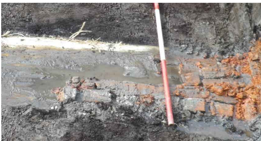
Figuur 14: De bakstenen muurfundering S190 is op een grenen houten plank gezet.
