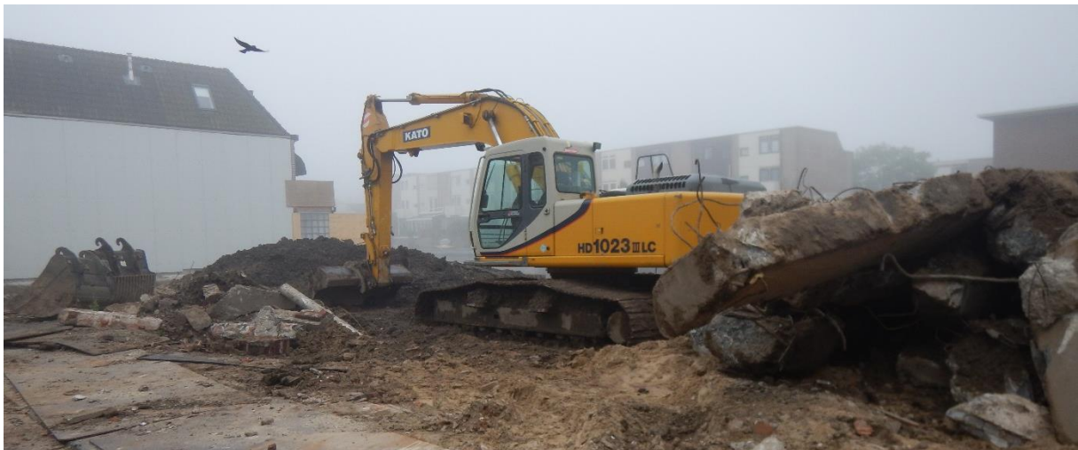
Figuur 6: Voorafgaand aan de archeologische begeleiding was al een deel van de funderingen, tegen de afspraak in, verwijderd. De opname is richting het zuidwesten gemaakt.
