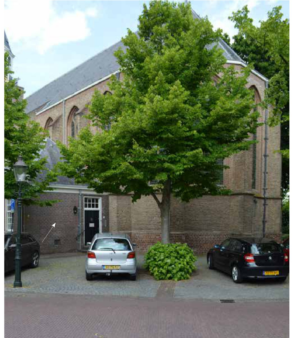
afbeelding 25. De achtergevel, gezien vanuit het oosten. Ter plaatse van de pijl werd in 1949 een venster in de gevel van de consistorie dichtgezet.
