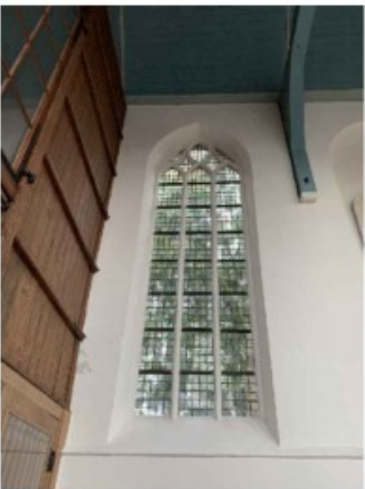
Foto kozijnmerk 3 (bestaand)
