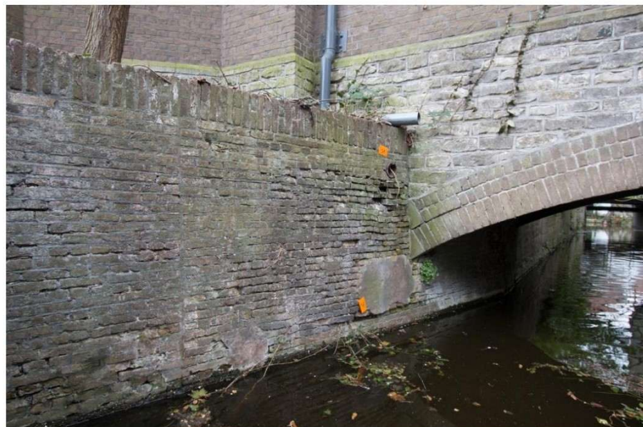
Markering van de plaats van de voorganger van de Kapelbrug in de vorm van twintigste-eeuws metselwerk. Links, moeilijk op de foto te zien, de verticale bouwnaad. De boog is aangebracht onder de overkluizing van gewapend beton.
