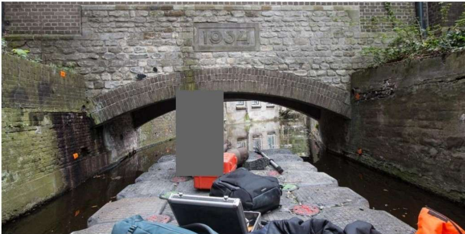
Onderzoek van het muurwerk vanaf een door de gemeente Gouda gefaciliteerd vaartuig. In de achtergrond de Kapeloverkluizing uit 1934.
