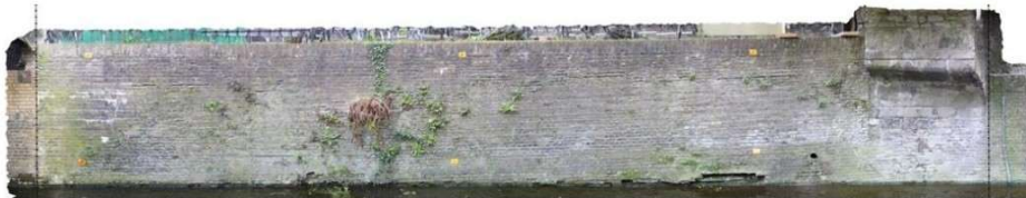
Metselwerk van sectie 7, van Koorbrug tot aan de eerste steunbeerconsole van het koor.
