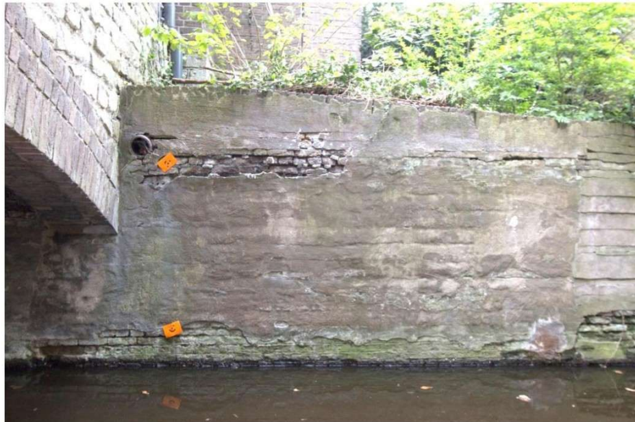
Op korte afstand van de overkluizing tekent zich een verticale naad af in de cementpleister. Mogelijk is hier sprake van een faseverschil.
