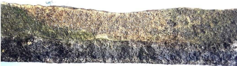
Hierboven kijken we in doorsnede op de cementlaag (grijs, onder) en op het deel van de baksteen dat bij het afbikken van de laag meekwam (geel, boven).
