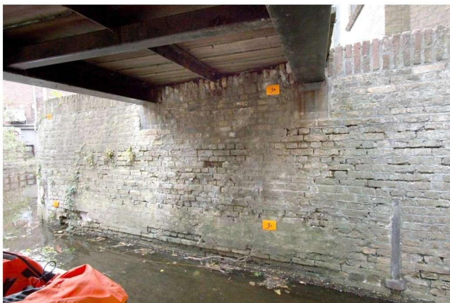
Aansluiting van de Kapelbrug op de kaaimuur. Brugoplegging is gerealiseerd in de bestaande kaaimuur.
