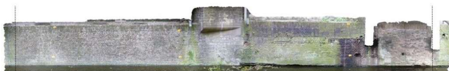
Metselwerk van sectie 8, het metselwerk vanaf de linker steunbeer tot en met de overkluizing.
