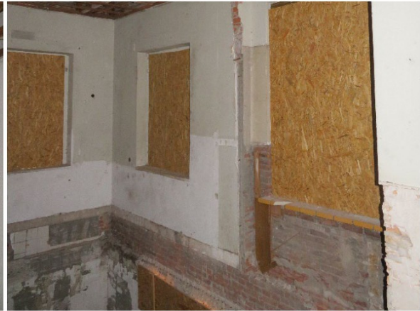
Achterzijde rechter beuk 1 e verdieping, vloer ontbreekt
