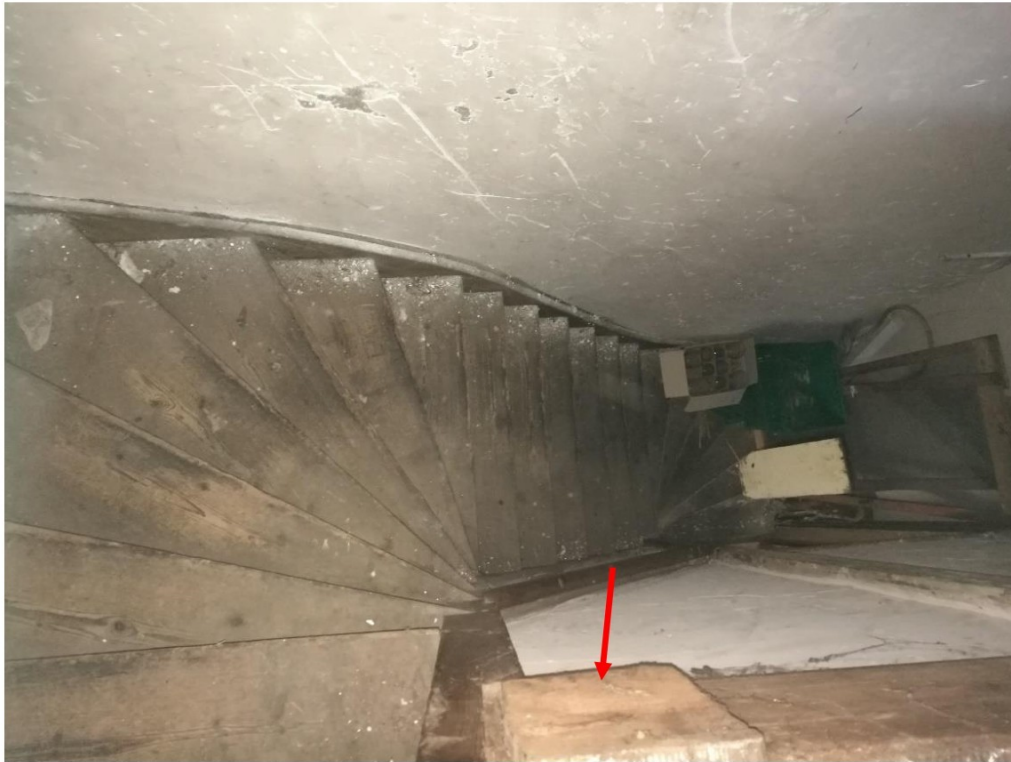
Figuur 14: Opname van de zoldertrap. De rode pijl markeert de afgezaagde vloerbalk.
