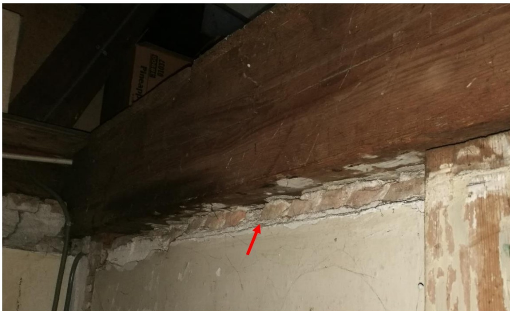
Figuur 15: Opname van de scheidingsmuur van de trapopgang naar de zolder. De rode pijl markeert de stroomlaag.
