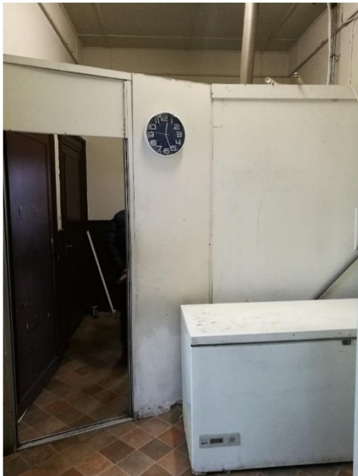
Figuur 11: De afgescheiden installatieruimte in de verkeersruimte. Links de deuren naar de zoldertrap en het toilet.
