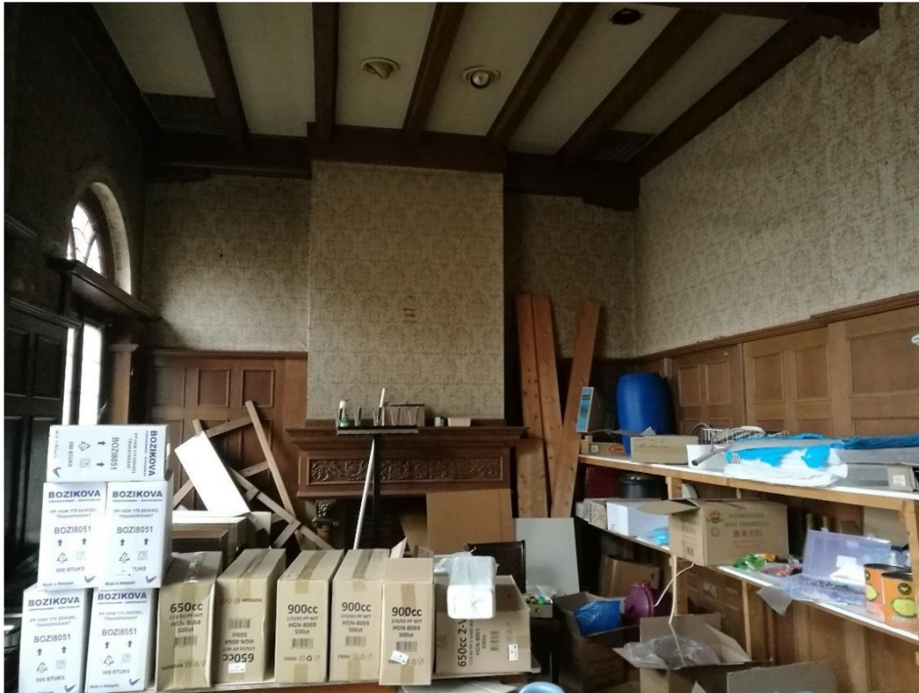
Figuur 8: Opname van de voormalige raadszaal in de richting van de linker bouwmuur. De balken hebben geen constructieve functie.
