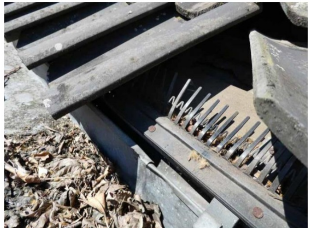
Figuur 12 Vogelschroten onder de dakpannen
